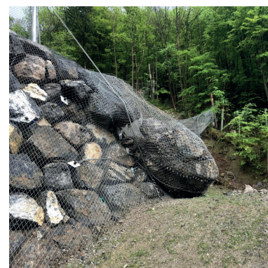
Murgang mit Blockschlag Axenstrasse Frühling 2020 (Bundesamt für Strassen)
